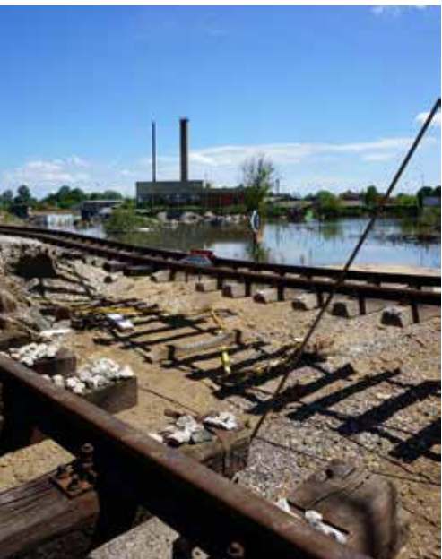
Velké povodně mohou poškodit důležitou dopravní infrastrukturu.
