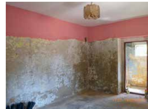
Pro lepší vysychání stěn odstraňte výmalbu.
