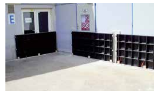
Průmyslové protipovodňové zábrany.
