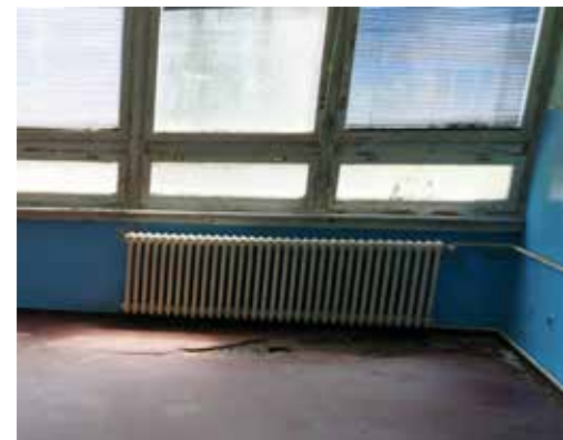
Popraskání podlahy vzlakem vody při zaplavování.
