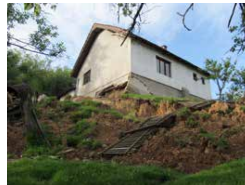
Přívalem srážky mohou způsobit podemletí základů.
