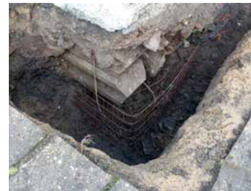
Porušené základy podbetonujte.
