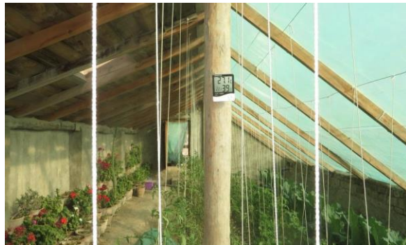
هایگرو میتر نصب شده در گلخانه که دارای ترمامیتر نیز میباشد
