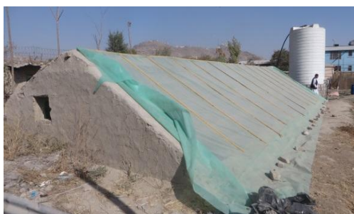
گلخانه با دیوار در سه سمت بطرف شرق، غرب و شمال رو به جنوب توسط پلاستیک پوش گردیده است - افغانستان
