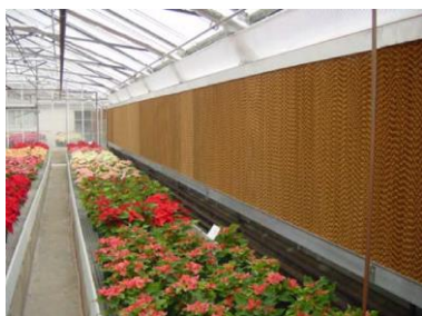
تخته های سرد کننده تبخیری در امتداد داخل دیوار ورودی تهویه نصب شده است
