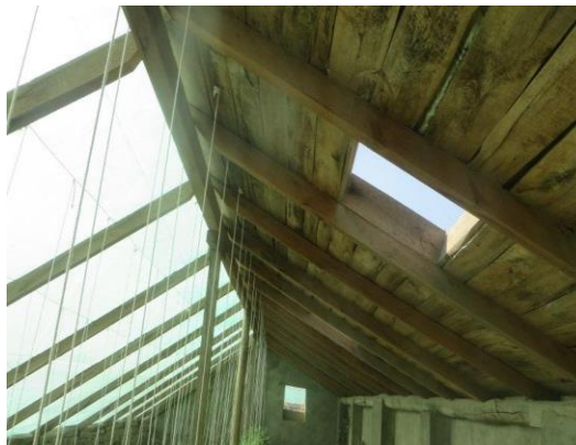
دریچه های تهویه در سقف گلخانه انستیتیوت کابل
