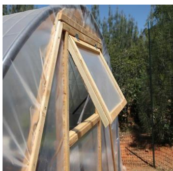
دریچه تهویه در قست اخیر گلخانه
